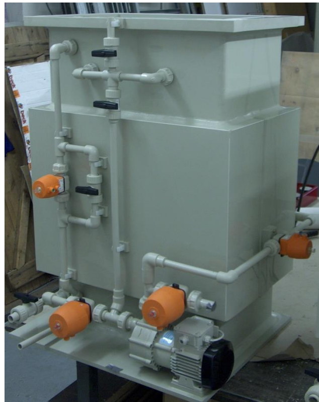
Elektrolytbehälter mit Pumpenverrohrung Kugelhähnen und Membranventilen Material PP
